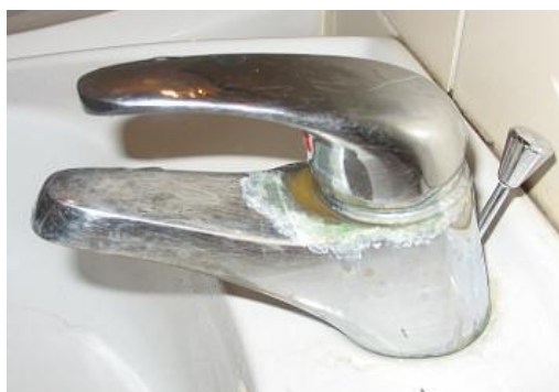
Слика 6 - Последице тврде воде
