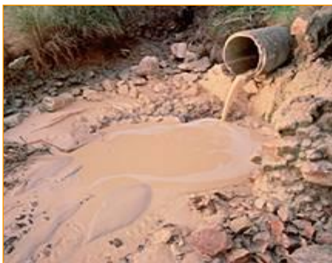
Слика 10.1.1 Неконтролисано испуштање отпадне воде
