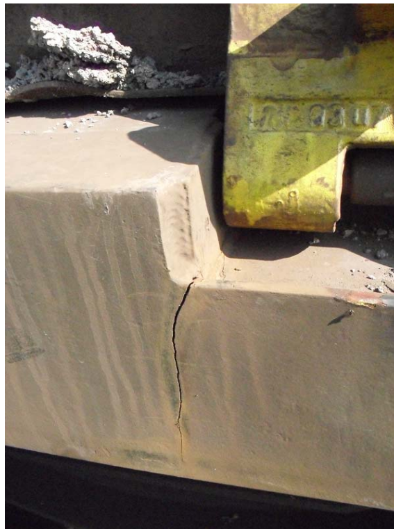
Слика 6.33 - Пукотина на конструкцији
