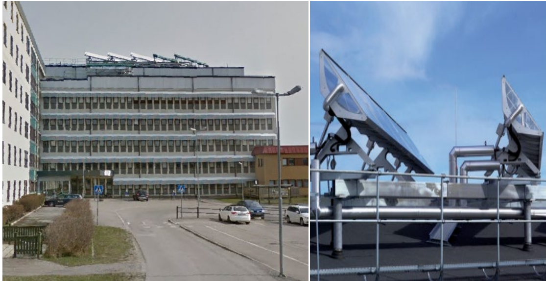
Слика 6.3.3.8. Инсталација Absolicon PV/T пријемника на крову локалне болнице у Harnosand -у, Шведска [26][31]
