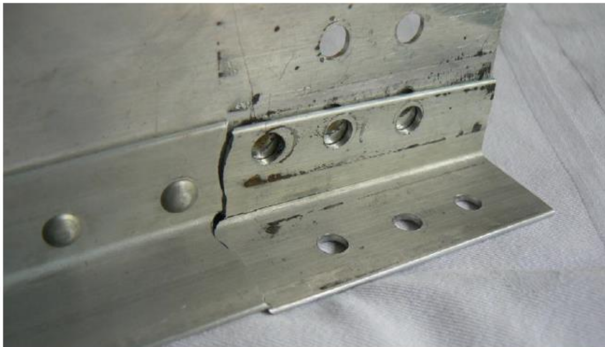
Слика 33: Изглед прслине доле десно, [1]
