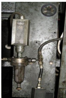
Слика 5.14 Прекидач притиска ваздуха и електромагнетни вентил за оптерећење
