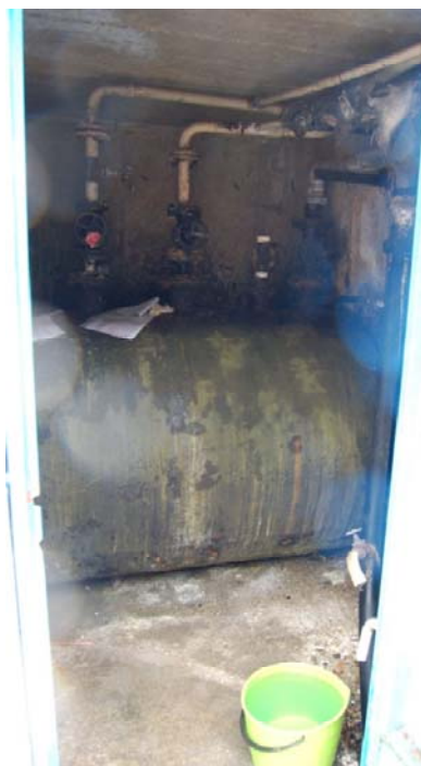
Слика 16.- Шахт за дозирање алуминијум- сулфата
