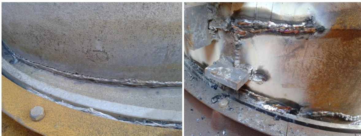
Слика 53. Прслина у зони утицаја топлоте вара на компензатору сателита (лево), заварен компензатор ватроотпорном електродом (десно)
