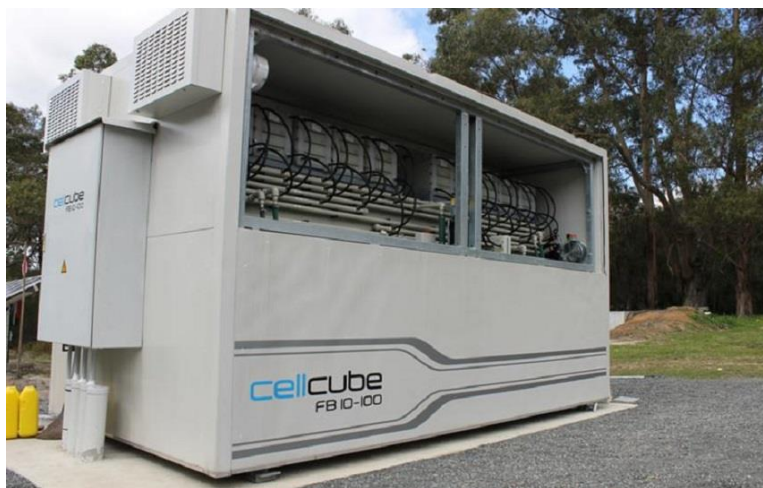
Слика 4.14 Ванадијум редокс проточна батерија [39]
