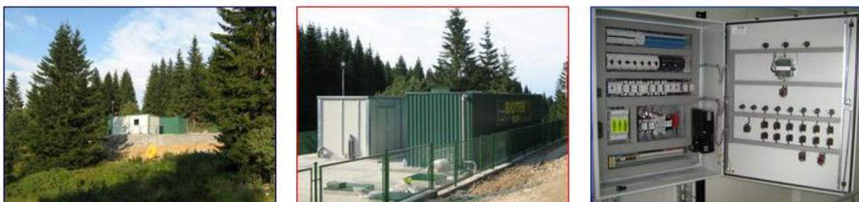
Слика 40. SBR постројење Сребренац, општина Брус [25]
