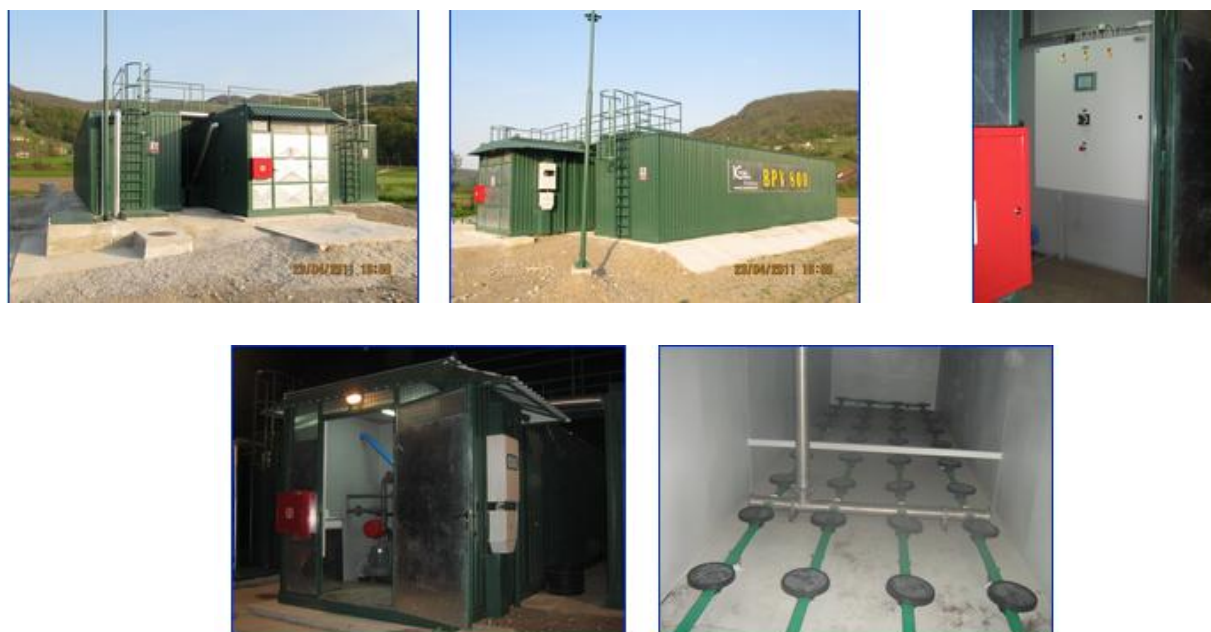
Слика 44. Постојење за пречишћавање комуналних отпадних вода, насеље Злакуса, град Ужице [25]
