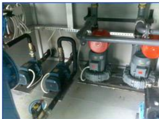
Слика 43. Постојење за пречишћавање санитарно-фекалних отпадних вода, ПЈ Коштунићи, општина Горњи Милановац [25]
