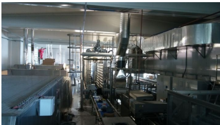
Прилог 5 - Пећ, складиште поклопаца, тунел за хлађење калупа и комора за хлађење
