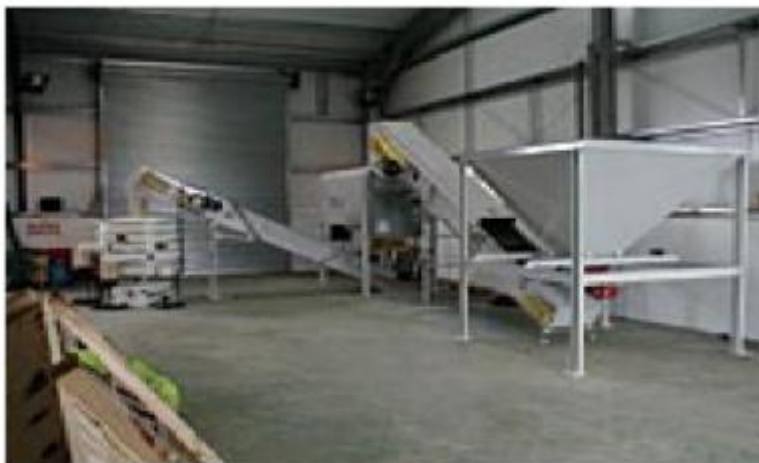
Слика 12. Изглед целокупног постројења (десно- Popper , лево- Kason класификатор)
