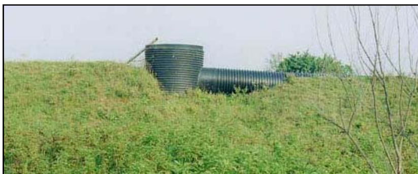
Слика 3.4. Ревизиона шахта на одводној линији OLB-III
