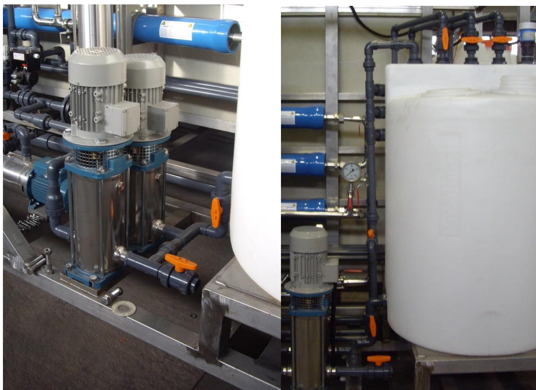
Слика 51 – Резервоар за прање (CIP) и пумпе за прање система
