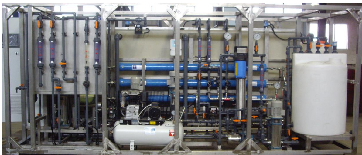
Слика 54 – Изглед читавог постројења
