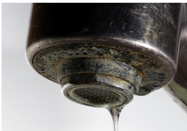
Слика 5 – Каменац као последица тврде воде
